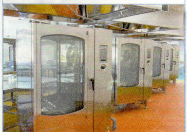
焼・揚調理室 蒸し料理も可能なスチームコンベクションオープンを導入し献立のレパートリーを増します。
